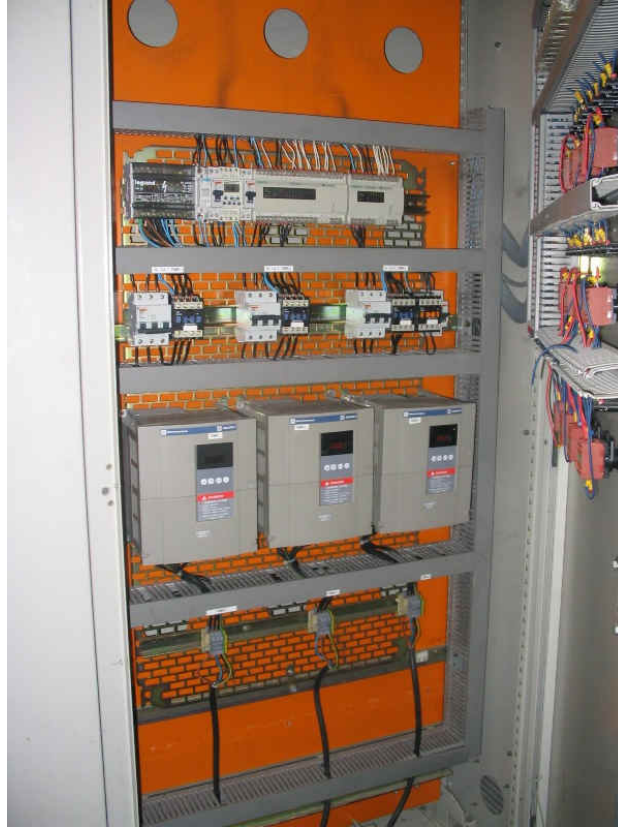
Réf : Coffret de commande de fontaine à Cannes-Mougins
