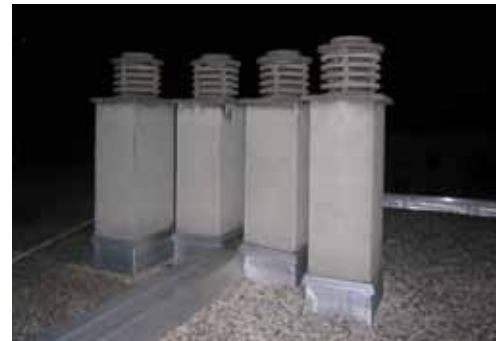
Sortie des conduits en toiture
