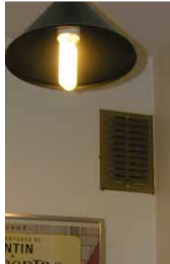
Grille de ventilation haute WC
